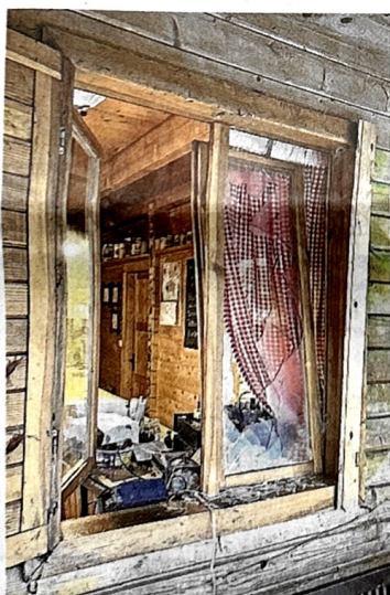
Über dieses Fenster hat sich ein Einbrecher Zutritt zur Hütte verschafft. Foto: Karl-Heinz Frank
